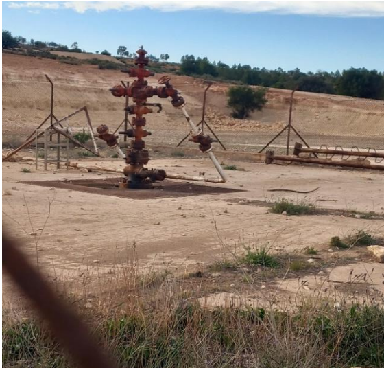
Figure : Tête de puits
